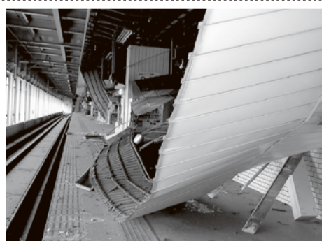
被災時の仙台駅新幹線ホーム
