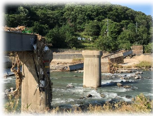
JR芸備線の狩留家-白木山間 寸断された第1三條川橋梁
